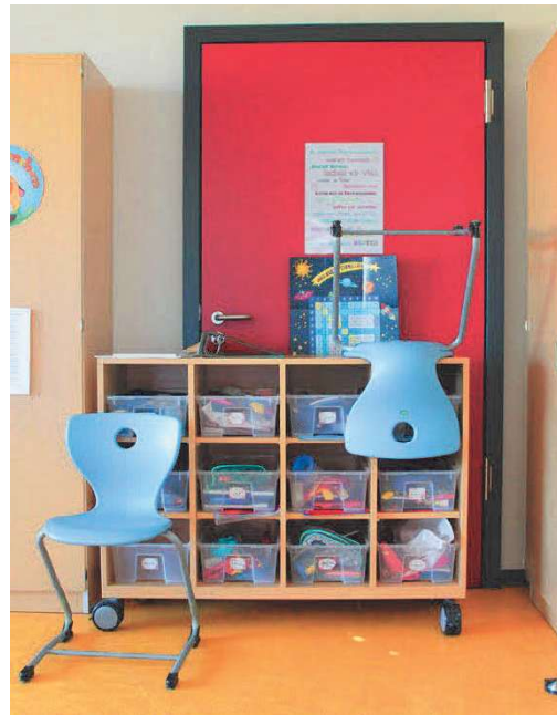
Abb. 2: Versperrter zweiter Rettungsweg
