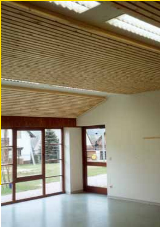
Raumakustische Maßnahme in einem Gruppenraum
